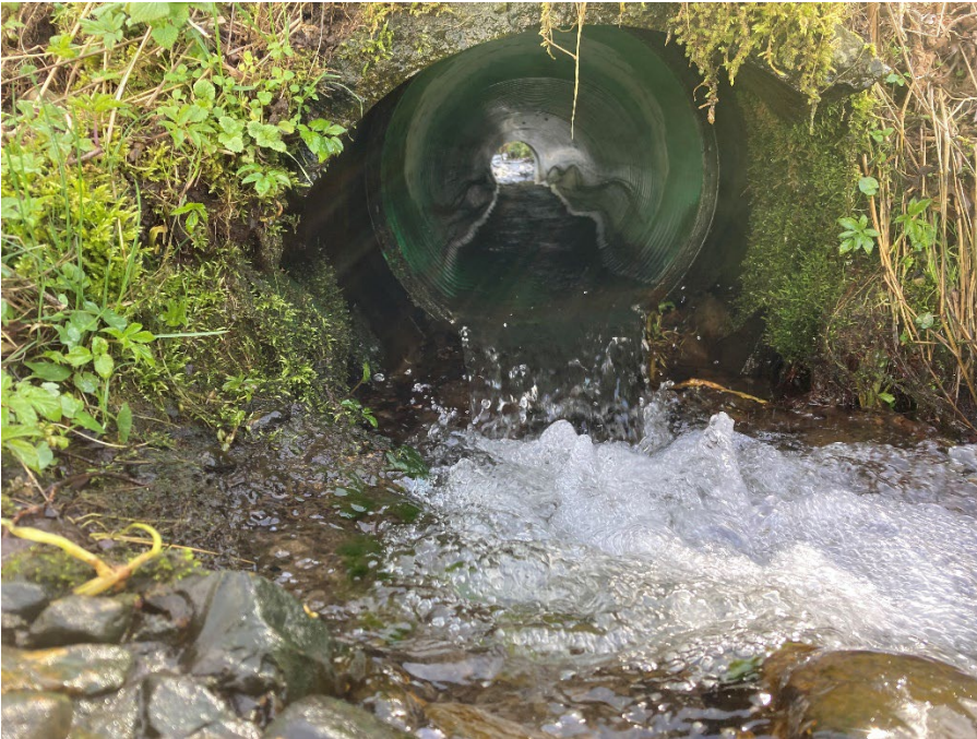
Figur 5. Fald ved udløbet fra røroverkørslen
